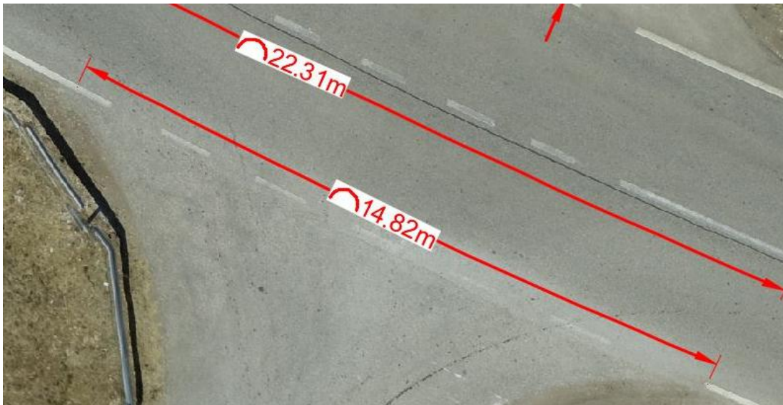
Slika 57 Oštećene oznake na kolniku na snimljenoj cesti s dimenzijama (uvećano)
