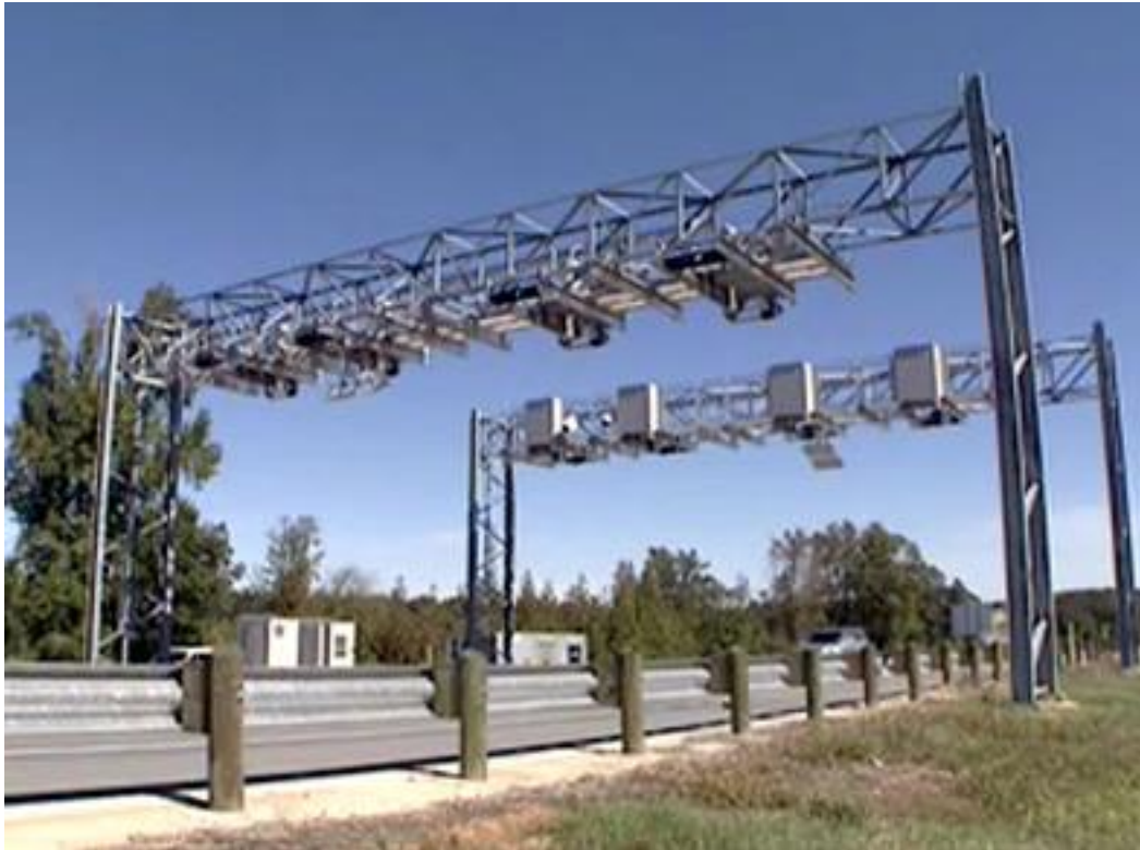
Slika 6: Infrastruktura za naplatu cestarine pri velikim brzinama
