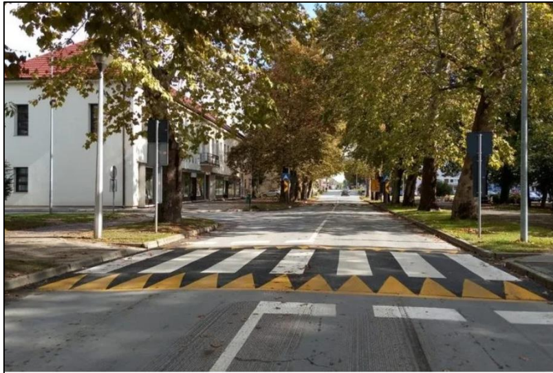
Slika 7 Izdignuće kolnika na široj površini. Izvor: [10]
