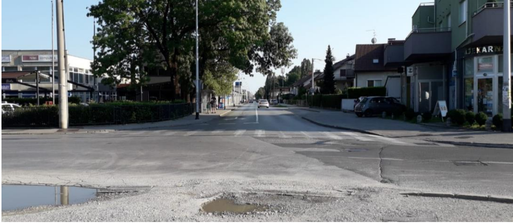
Slika 22. Deformacije na kolniku
