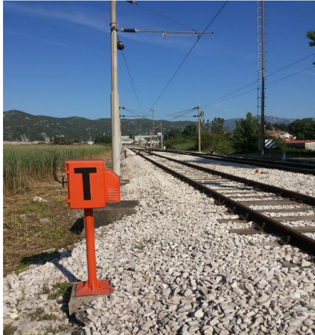
Slika 7. Telefonski ormarić u kolodvoru Ploče
