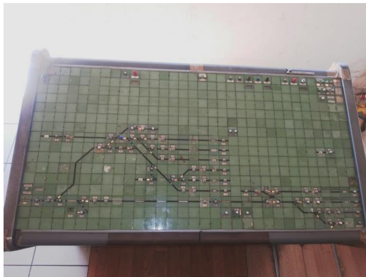
Slika 10. Postavni stol elektro-relejnog uređaja „Iskra-Lorenz“ u prometnom uredu kolodvora Ploče
