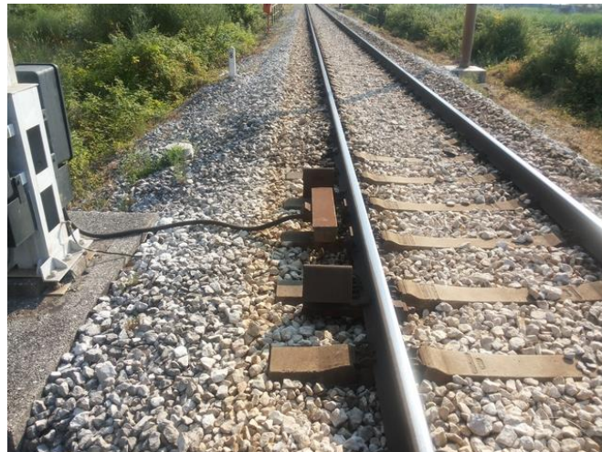
Slika 12. Pružna baliza kod ulaznog signala AT
