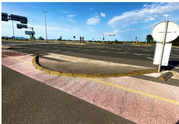
Slika 19. Nepravilno izveden prometni otok na križanju Velikogoričke obilaznice i Ulice Rudolfa Fizira
