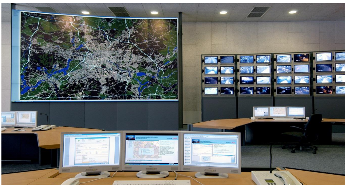
Slika 4. Prikaz prostorije Centra za održavanje i kontrolu prometa koja prati stanje na autocestama i tunelima.
