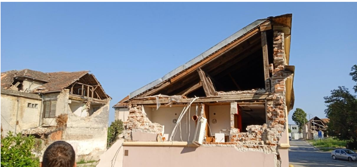
Slika 34. Zatečeno stanje objekta klasificiranog s manjim oštećenjima-3.primjer
