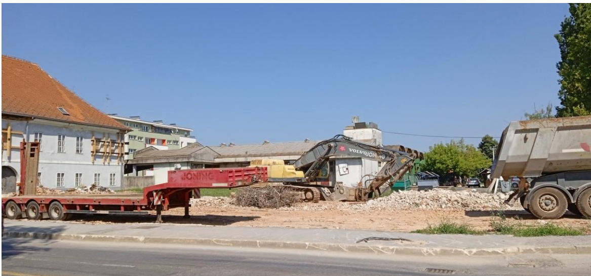
Slika 30. Zatečeno stanje objekta klasificiranog s manjim oštećenjima-1.primjer
