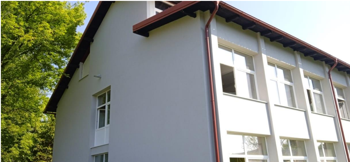
Slika 36. Zatečeno stanje objekta klasificiranog s većim oštećenjima-4.primjer
