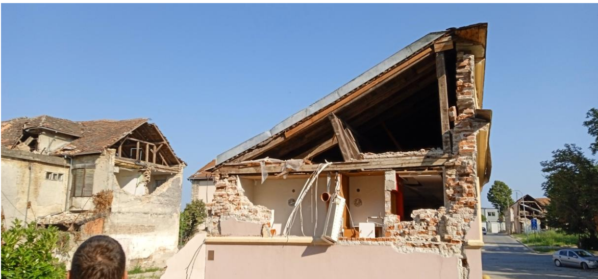
Slika 34. Zatečeno stanje objekta klasificiranog s manjim oštećenjima-3.primjer
