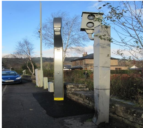
Slika 22. Kamera za nadzor željezničko-cestovnog prijelaza [27]
