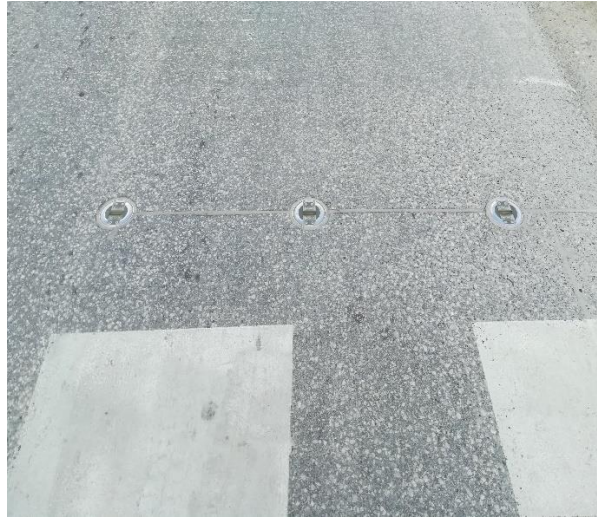
Slika 34. LED svjetla ugrađena u cestu na željezničko-cestovnom prijelazu Poznanovec
