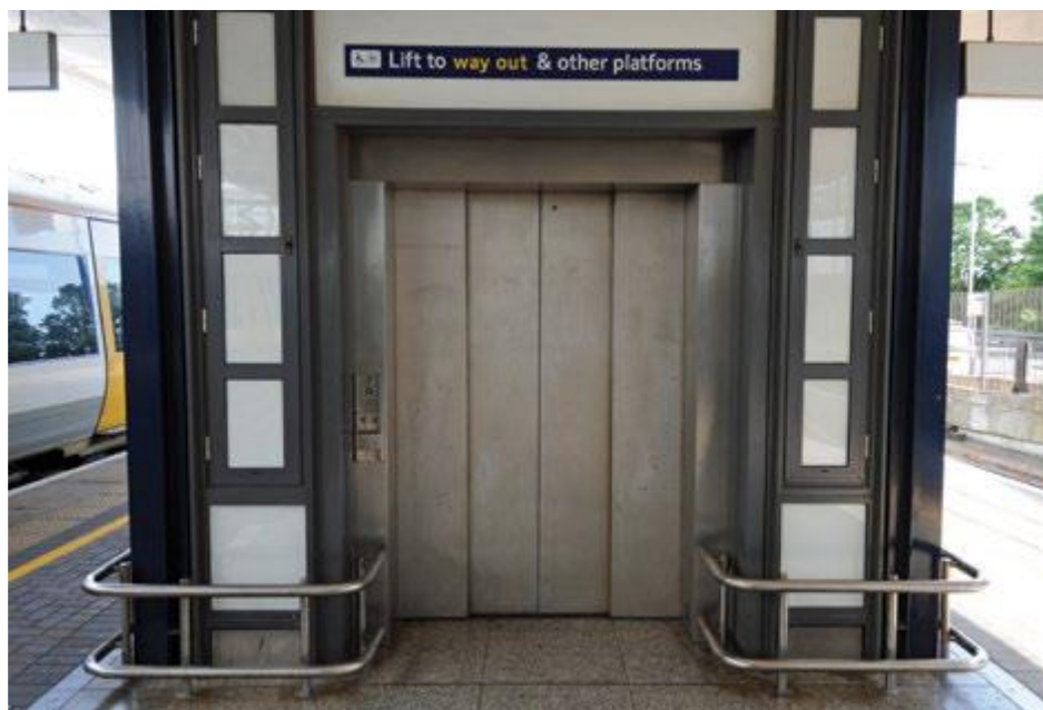
Slika 13: Prikaz lifta na željezničkom peronu [9]
