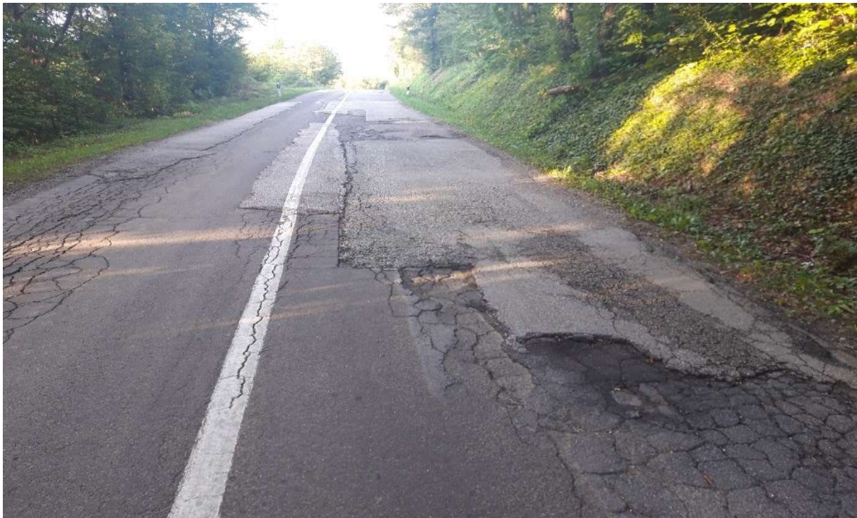
Slika 6. Dio kolnika na županijskoj cesti ŽC 2169 u gradu Zlatar
