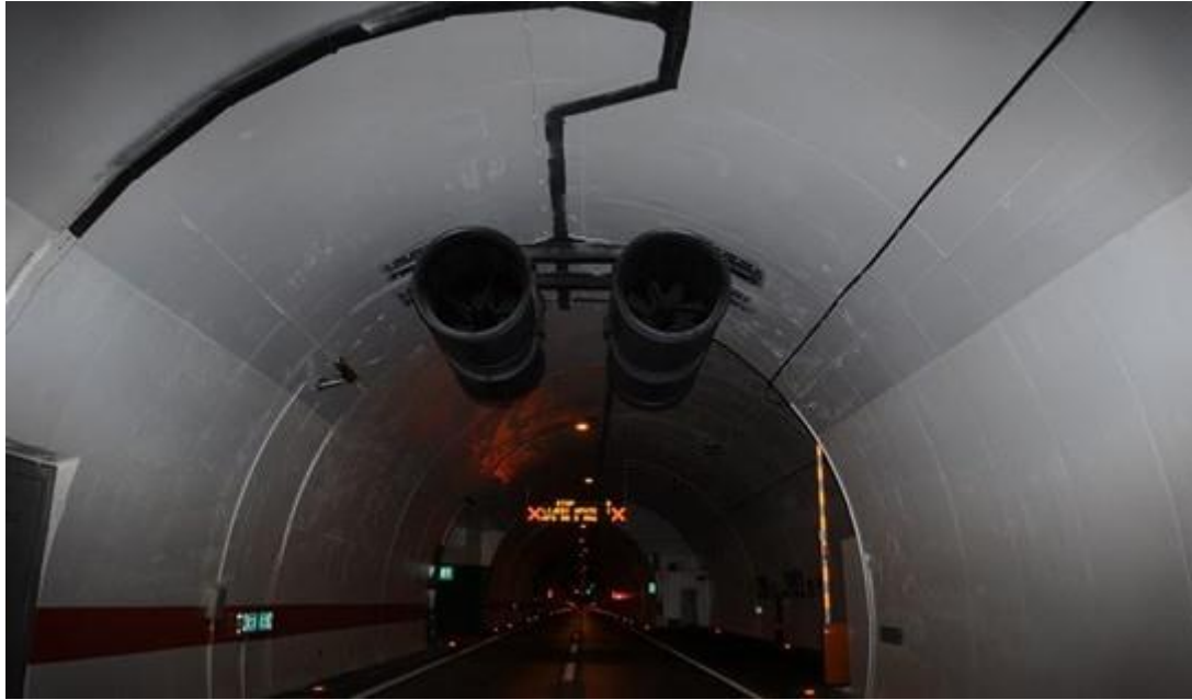
Slika 27. Provjetravanje tunela Mala Kapela, [2]
