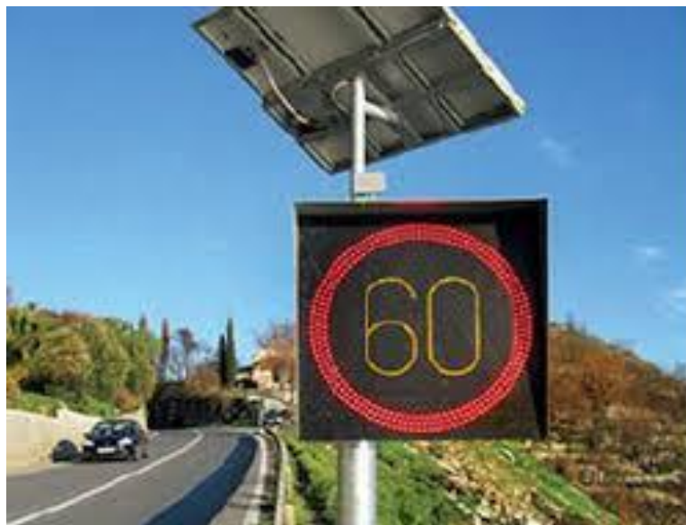
Slika 9. LED prometna signalizacija
