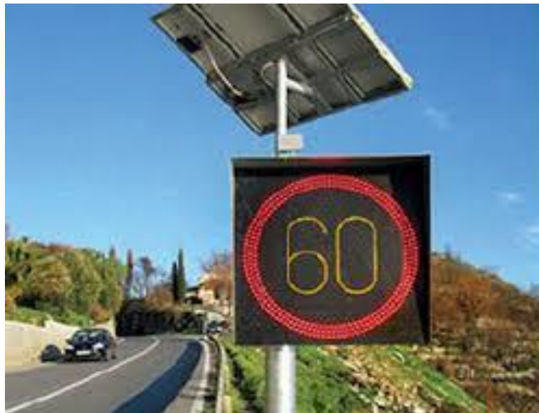
Slika 9. LED prometna signalizacija
