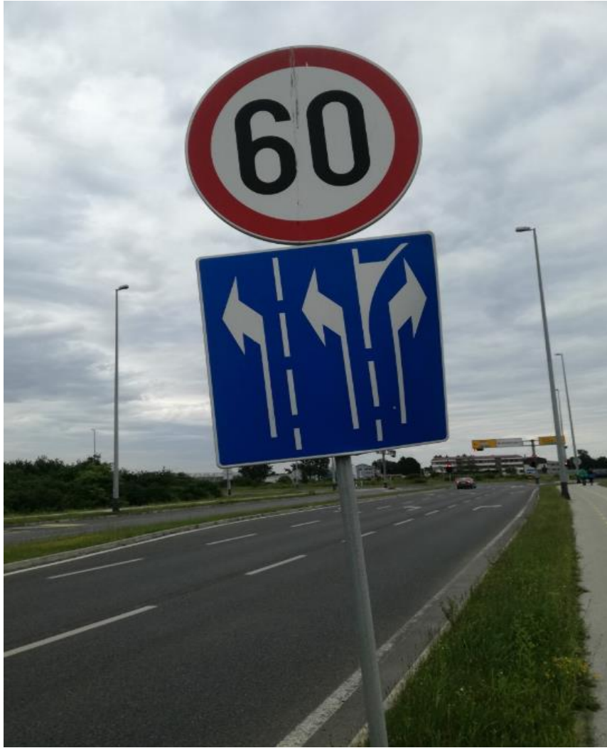
Slika 16. Prikaz oštećenog prometnog znaka na istočnom kolniku Avenije pape Ivana Pavla II
