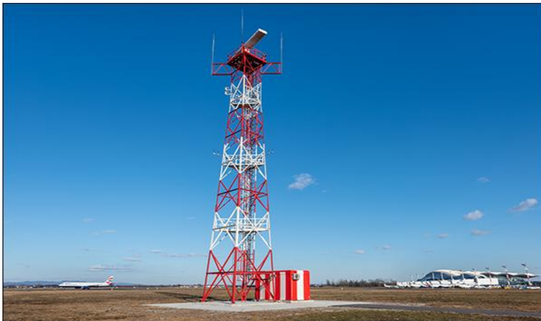
Slika 10. Prikaz novoinstalirane antene A-SMGCS-a na Zračnoj luci Zagreb. [14]
