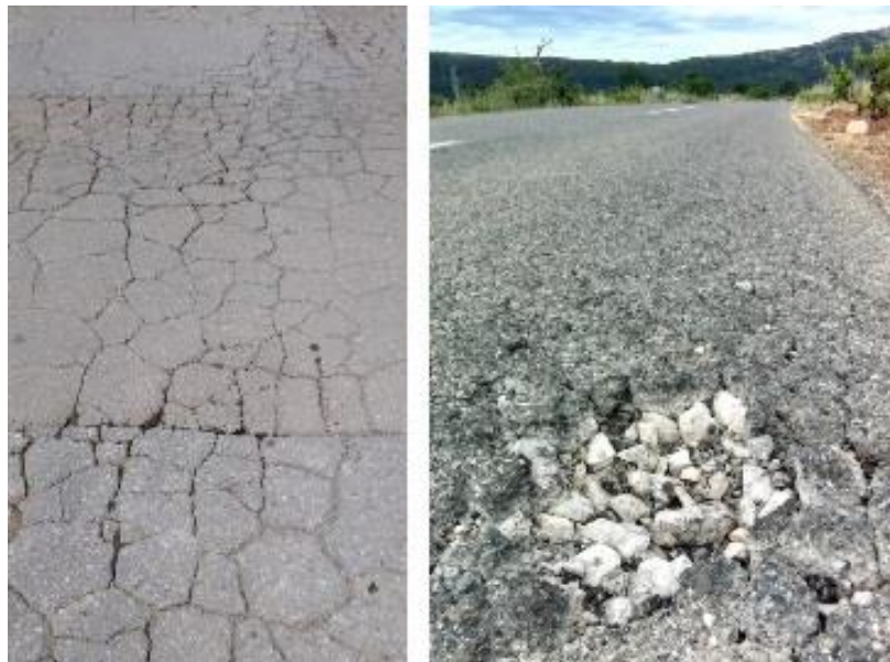
Slika 12. Pukotine na voznoj površini i udarna rupa
