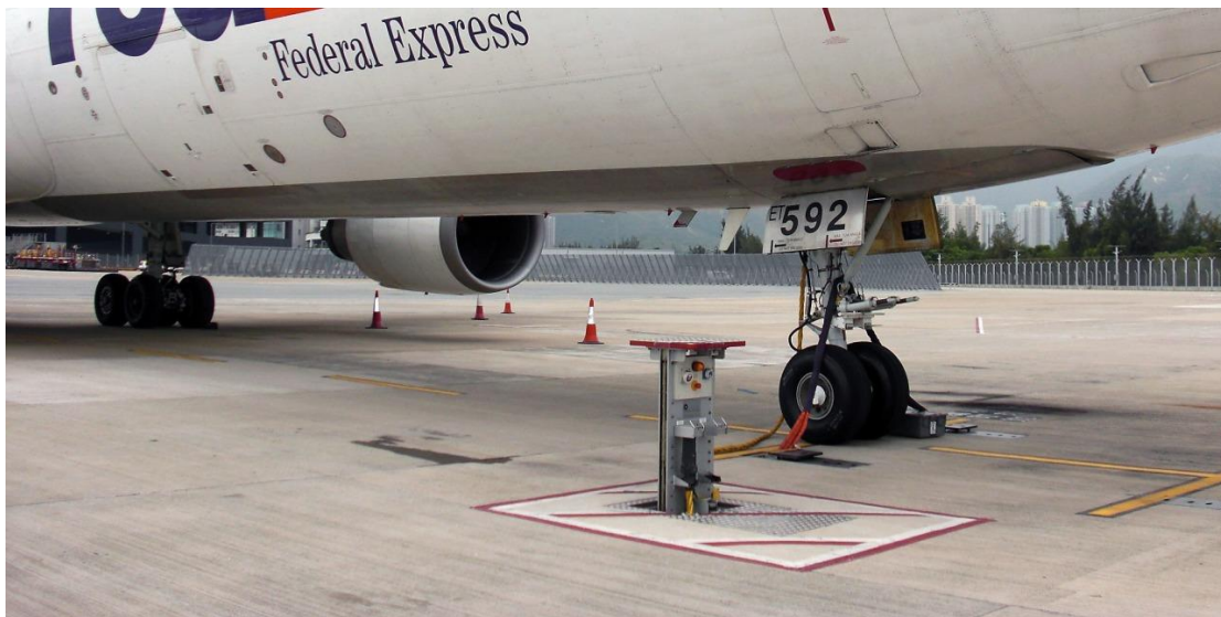
Slika 15. Fiksna oprema za gorivo, [10]
