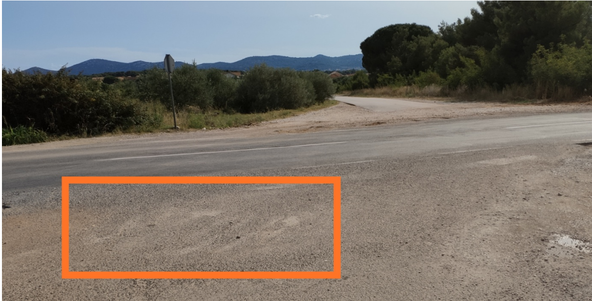
Slika 21. Jedva vidljiva oznaka STOP na sjevernom privozu
