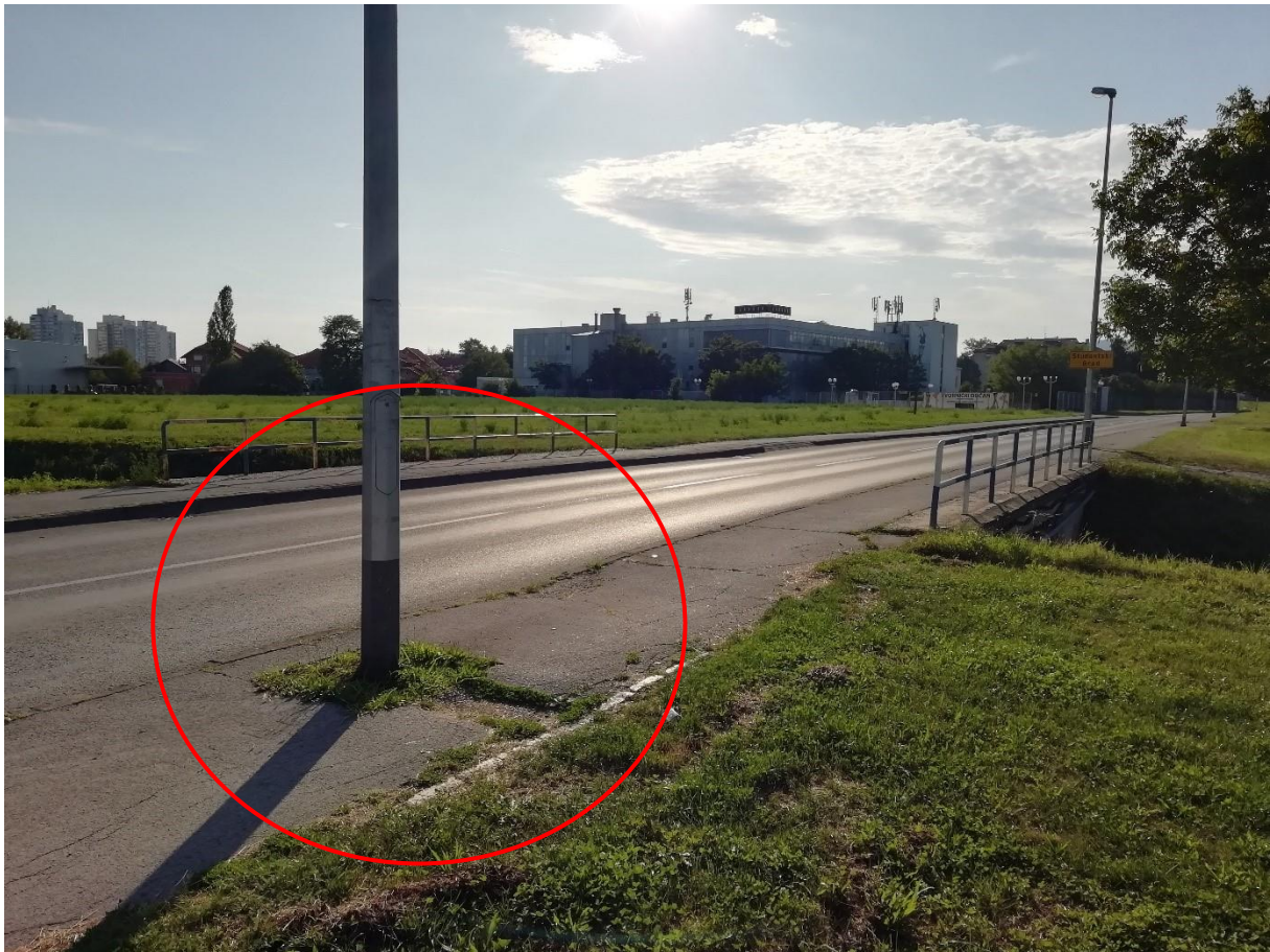
Slika 25. Prikaz oštećenja na pješačkoj stazi
