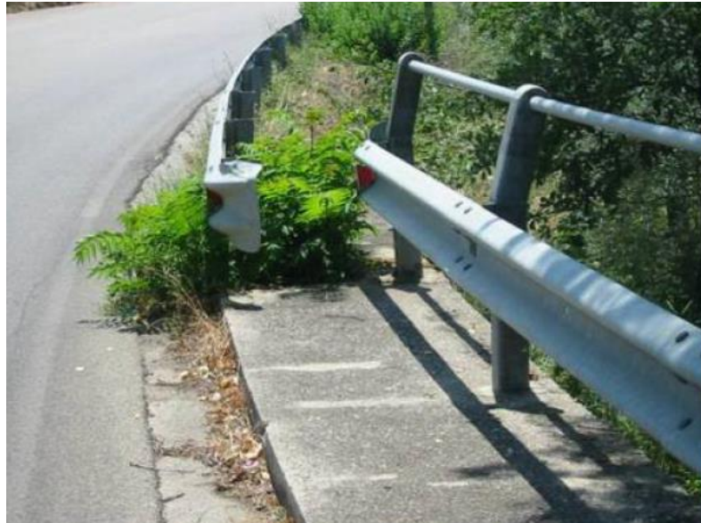
Slika 9. Neusklađenost zaštitne ograda uz kolnik i na mostu - bez spoja
