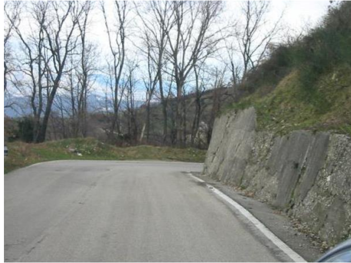
Slika 7. Nedostatak ploča za označavanje oštrog zavoja
