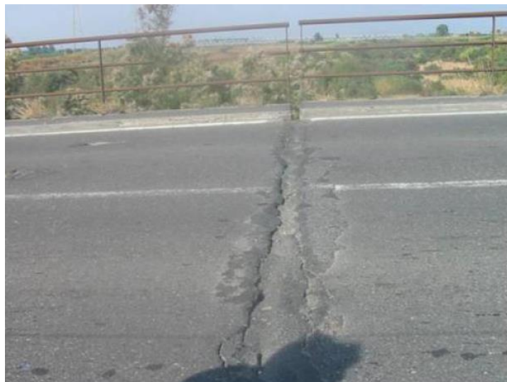
Slika 8. Oštećeni spoj na mostu
