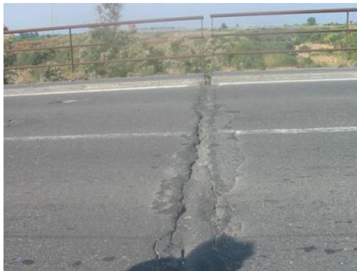
Slika 8. Oštećeni spoj na mostu
