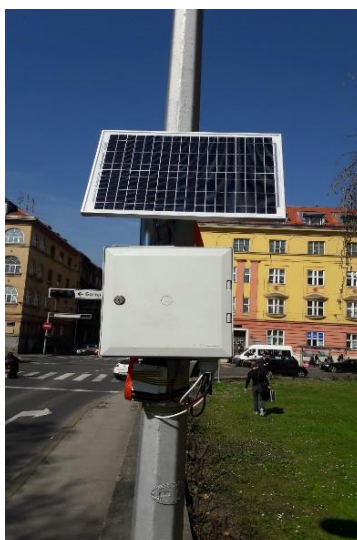
Slika 14 Oprema za mjerenje postavljena na rasvjetnom stupu u Miramarskoj ulici
