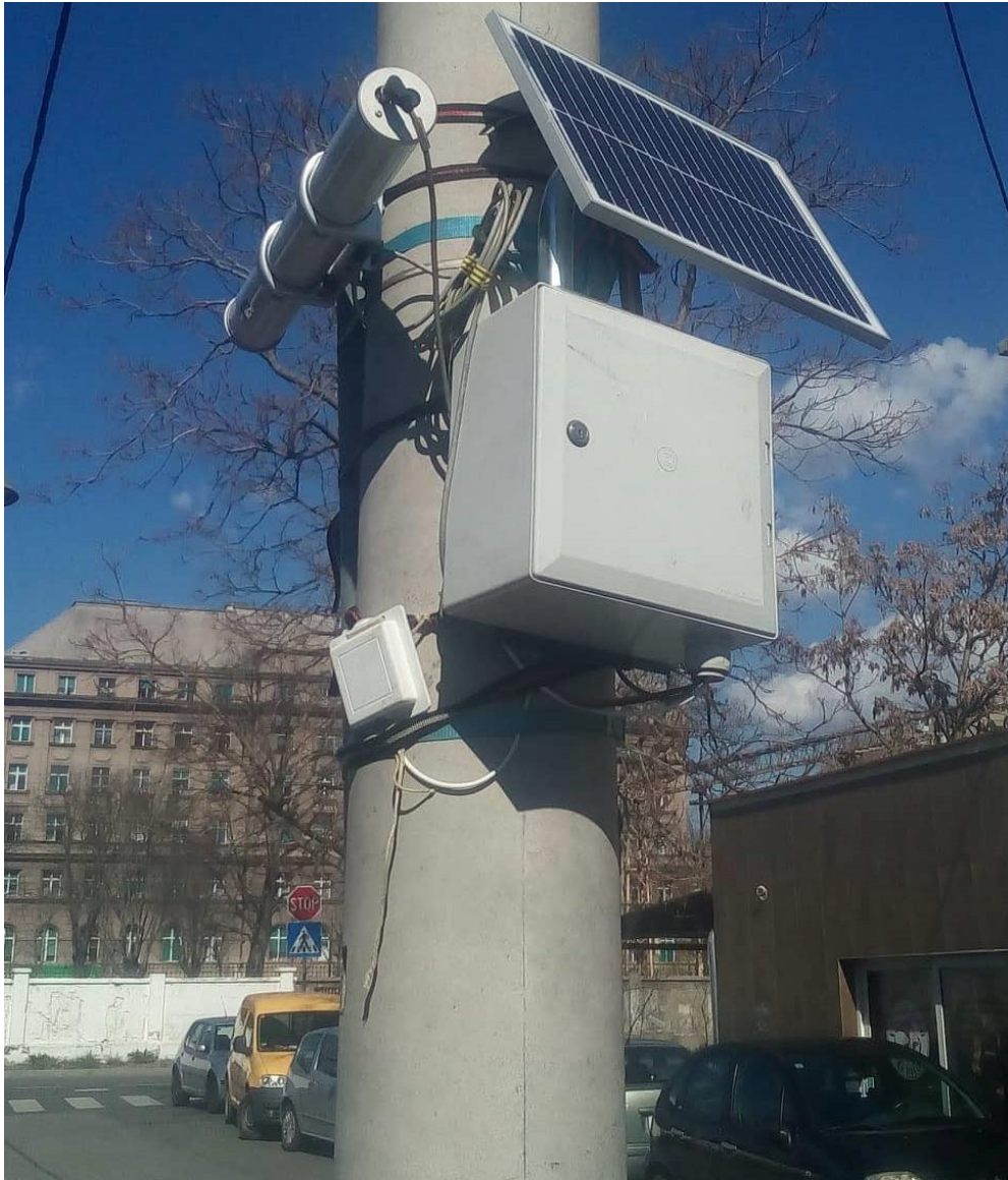
Slika 10. Postavljeni radar i BT detektor na stupu kod Miramarskog podvožnjaka
