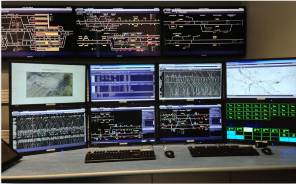
Slika 23. Izgled jedinice za upravljanje linija metro sustava
