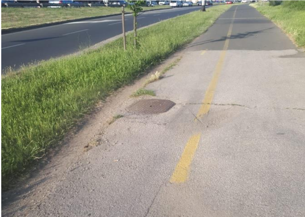
Slika 23. Primjer lošeg održavanja – Zagrebačka avenija [Autor]
