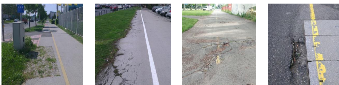
a) b) c) d) Slika 5.11. Primjeri oštećenja na biciklističkim stazama u Zagrebu
