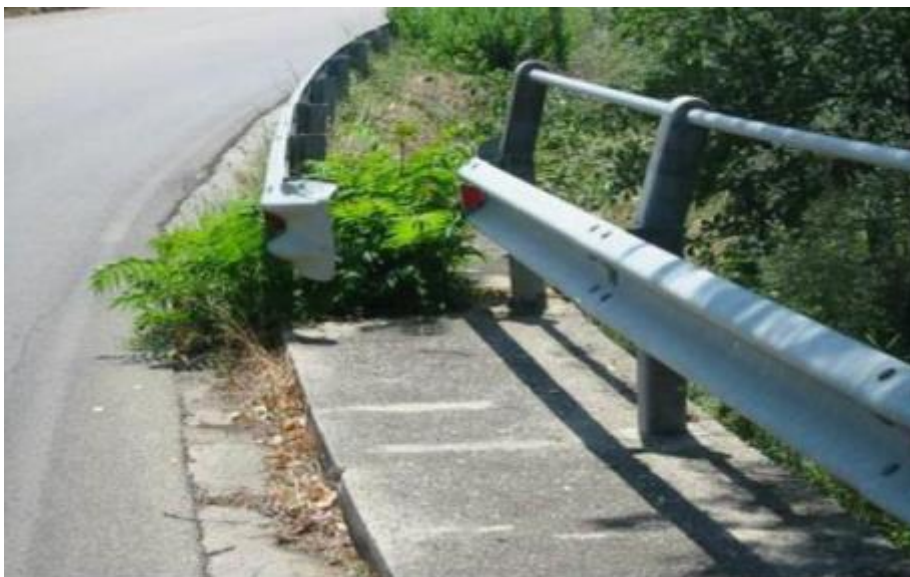
Slika 20. Neusklađenost zaštitne ograde na mostu i uz kolnik
