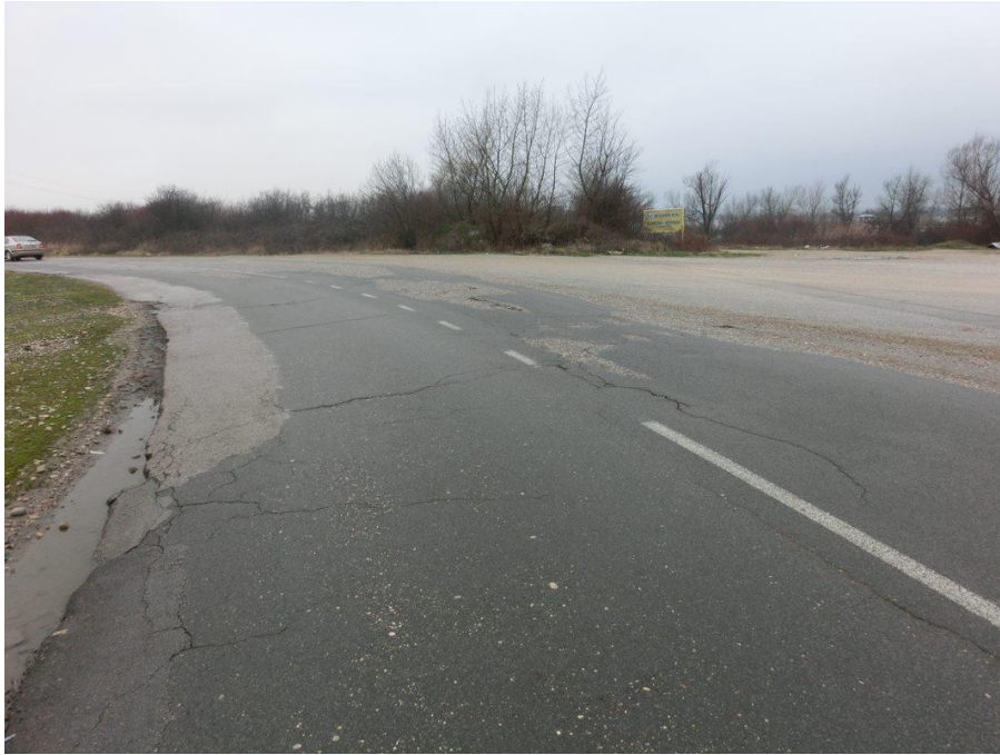
Slika 19. Oštećen kolnik u zavoju.
