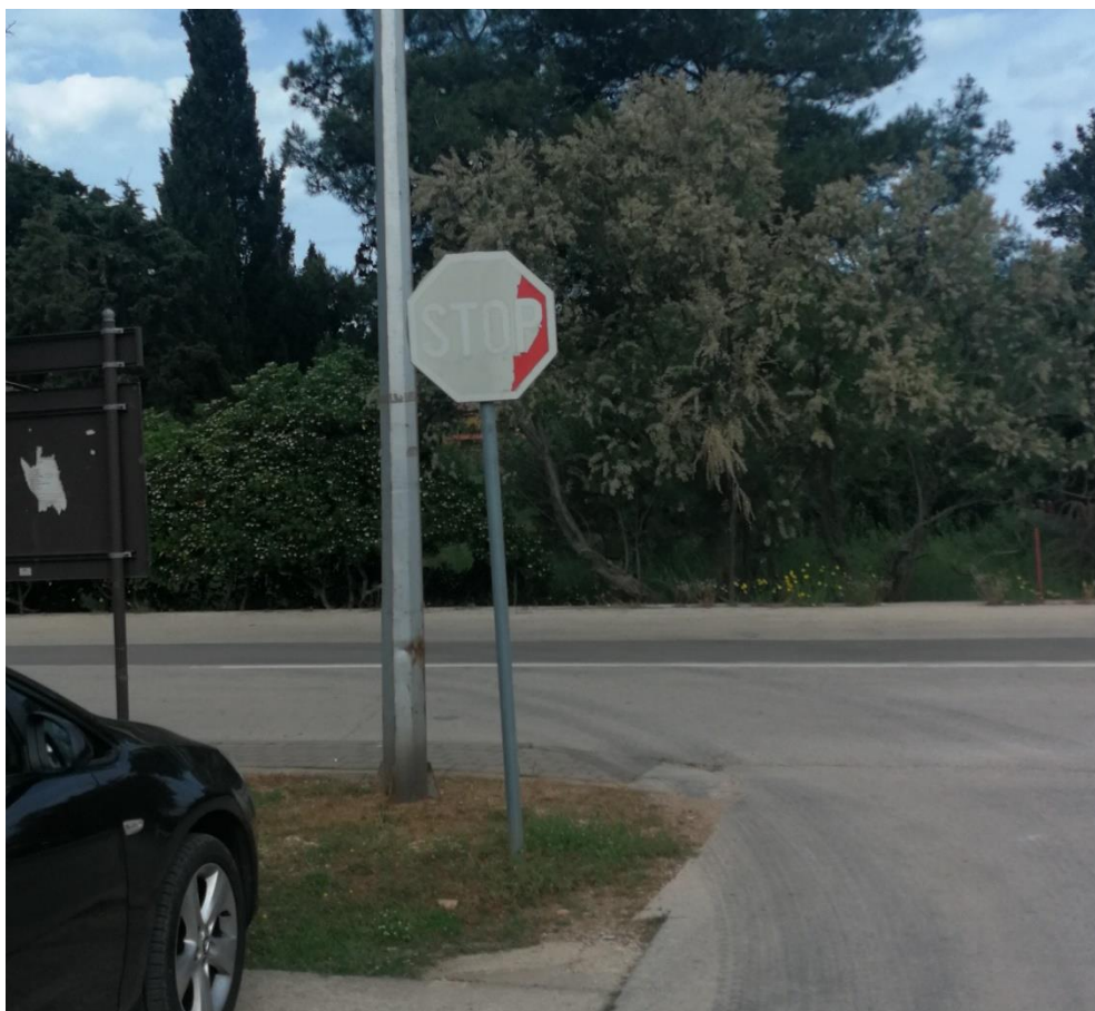
Slika 18. Prometni znak B02 – Obavezno zaustavljanje, oštećenja folija znaka
