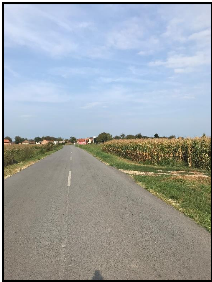
Slika 30. Stanje kolnika na lokaciji „4“
