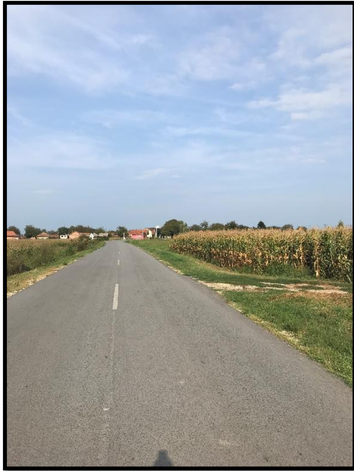
Slika 30. Stanje kolnika na lokaciji „4“
