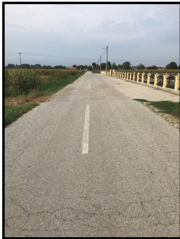
Slika 27. Postojeće stanje kolnika LC25103
