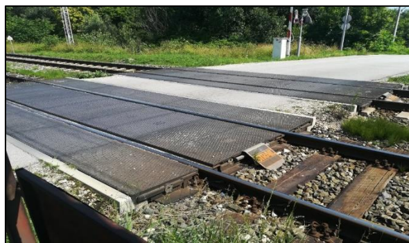
Slika 103. Prikaz stanja gumirane podloge na željezničko-cestovnom prijelazu „Utinjska“
