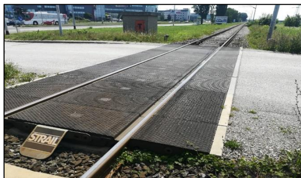
Slika 119. Prikaz stanja gumirane podloge na željezničko-cestovnom prijelazu „Buzin“
