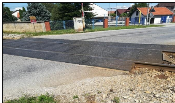
Slika 79. Prikaz stanja gumirane podloge na željezničko-cestovnom prijelazu „Bedekova“
