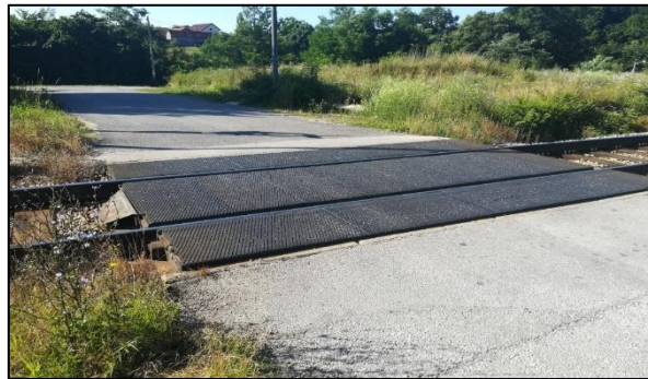
Slika 67. Prikaz stanja gumirane podloge na željezničko-cestovnom prijelazu „Horvati“
