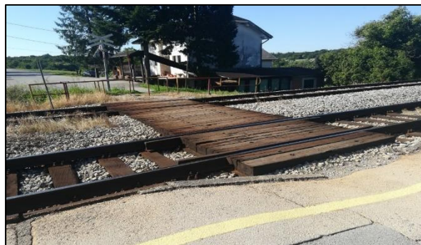
Slika 71. Prikaz stanja drvenih pragova na željezničko-cestovnom prijelazu „Horvati pp“
