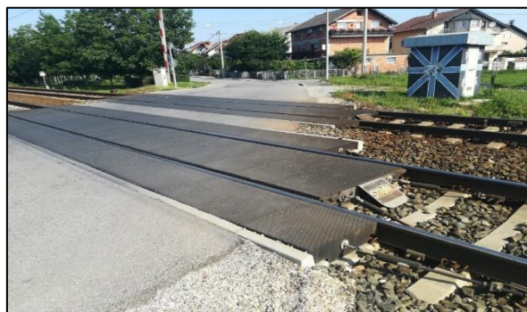
Slika 47. Prikaz stanja gumirane podloge na željezničko-cestovnom prijelazu „Selnica“
