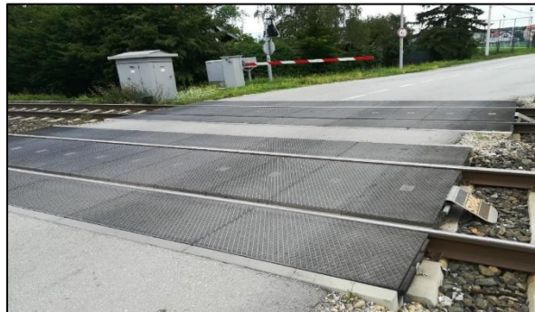
Slika 55. Prikaz stanja gumirane podloge na željezničko-cestovnom prijelazu „Dumovec“
