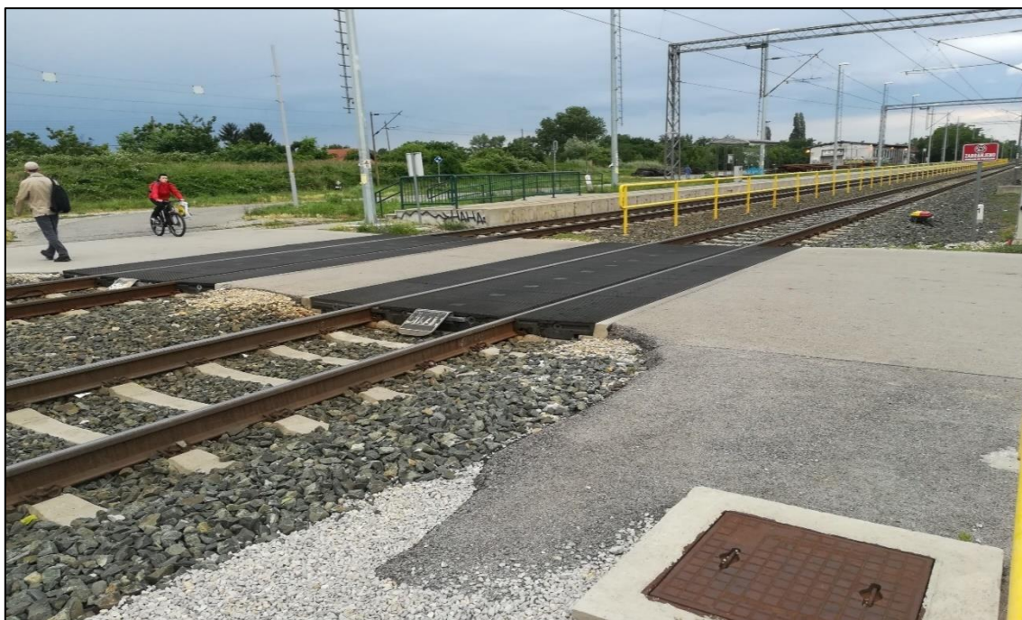
Slika 10. Prikaz stanja gumiranih ploča na željezničko-cestovnom prijelazu „Trnava“
