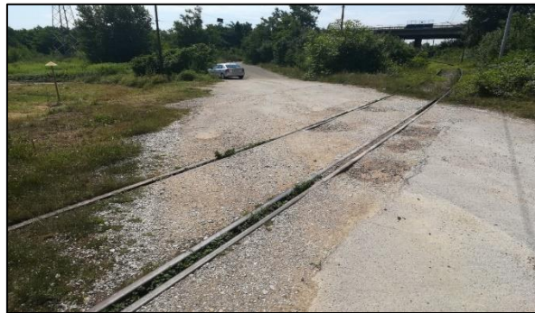
Slika 115. Prikaz stanja asfaltne podloge na željezničko-cestovnom prijelazu „Horvatova 2“
