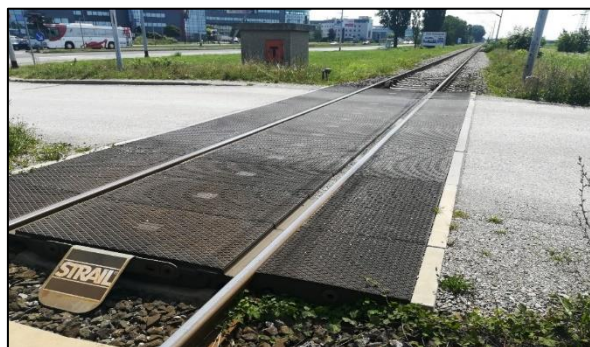
Slika 119. Prikaz stanja gumirane podloge na željezničko-cestovnom prijelazu „Buzin“
