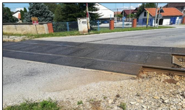
Slika 79. Prikaz stanja gumirane podloge na željezničko-cestovnom prijelazu „Bedekova“
