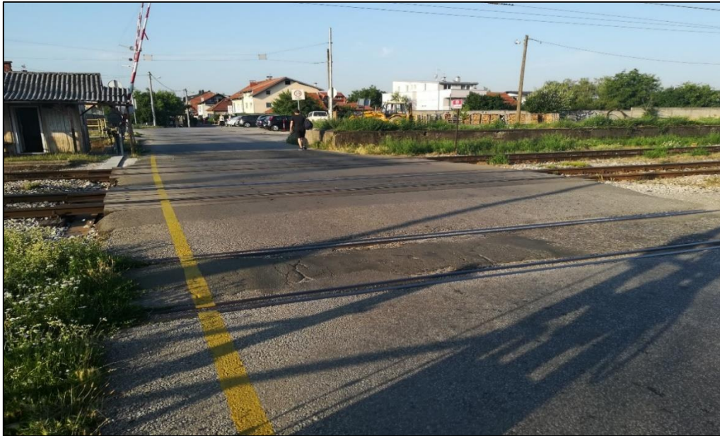
Slika 27. Prikaz stanja asfaltne podloge i drvenih pragova na željezničko-cestovnom prijelazu „Sokolska“
