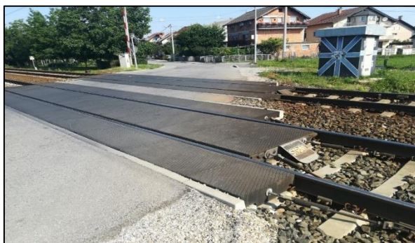
Slika 47. Prikaz stanja gumirane podloge na željezničko-cestovnom prijelazu „Selnica“
