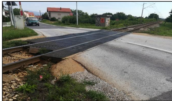
Slika 91. Prikaz stanja gumirane podloge na željezničko-cestovnom prijelazu „Brezovečka“
