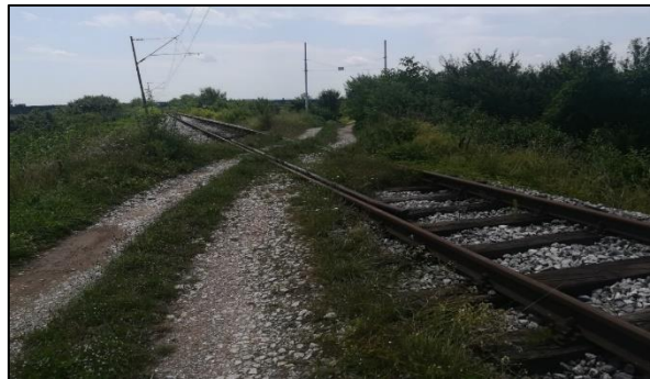
Slika 135. Prikaz stanja kamene podloge na željezničko-cestovnom prijelazu „Poljski put“
