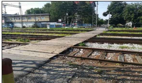
Slika 39. Prikaz stanja drvenih pragova na željezničko-cestovnom prijelazu „Sljeme“
