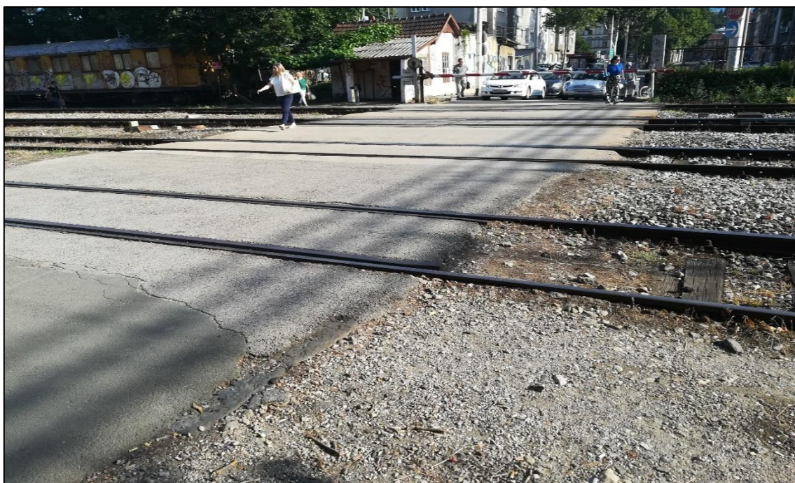
Slika 19. Prikaz stanja asfaltne podloge na željezničko-cestovnom prijelazu „R. Austrije“
