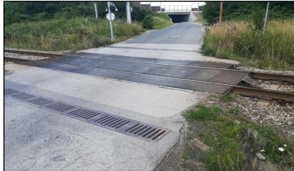
Slika 83. Prikaz stanja gumirane podloge na željezničko-cestovnom prijelazu „Demerje“
