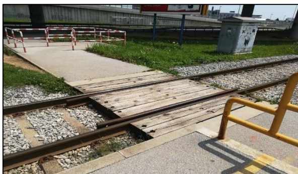
Slika 127. Prikaz stanja drvenih pragova na željezničko-cestovnom prijelazu „Odra St.“
