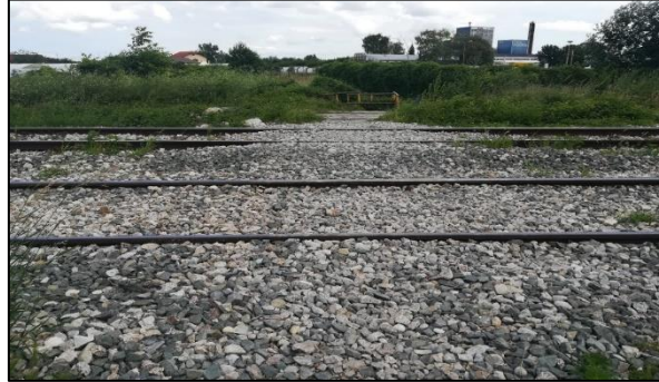
Slika 141. Prikaz stanja kamene podloge na željezničko-cestovnom prijelazu „Resnik“
