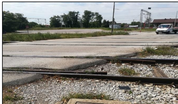
Slika 111. Prikaz stanja asfaltne podloge na željezničko-cestovnom prijelazu „Horvatova“
