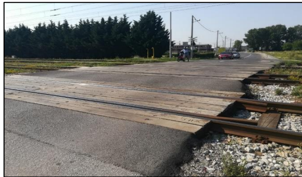
Slika 43. Prikaz stanja drvenih pragova na željezničko-cestovnom prijelazu „Jelkovečka“
