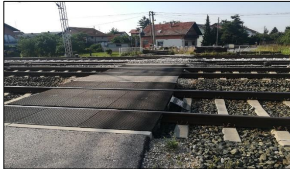
Slika 35. Prikaz stanja gumiranih ploča na željezničko-cestovnom prijelazu „Treska“
