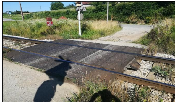
Slika 75. Prikaz stanja gumirane podloge na željezničko-cestovnom prijelazu „Prevendari“
