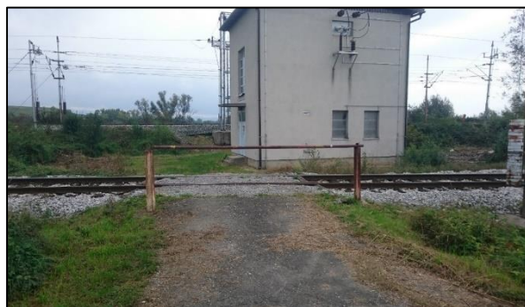
Slika 137. Željezničko-cestovni prijelaz „Trafostanica“ i prikaz stanja njegove kamene podloge
