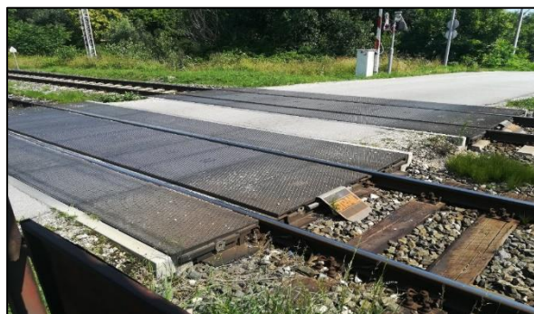
Slika 103. Prikaz stanja gumirane podloge na željezničko-cestovnom prijelazu „Utinjska“
