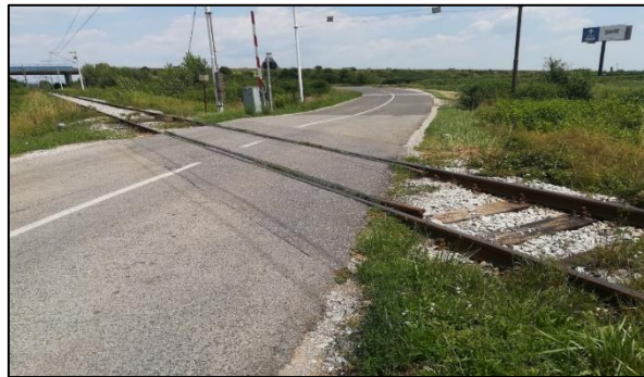
Slika 131. Prikaz stanja asfaltne podloge na željezničko-cestovnom prijelazu „Mićevac“
