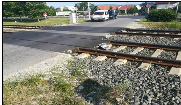
Slika 63. Prikaz stanja gumirane podloge na željezničko-cestovnom prijelazu „Retkovec 3“
