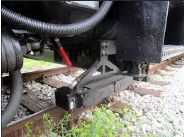
Slika 23. Ugrađena lokomotivska baliza na vozilu [autor]
