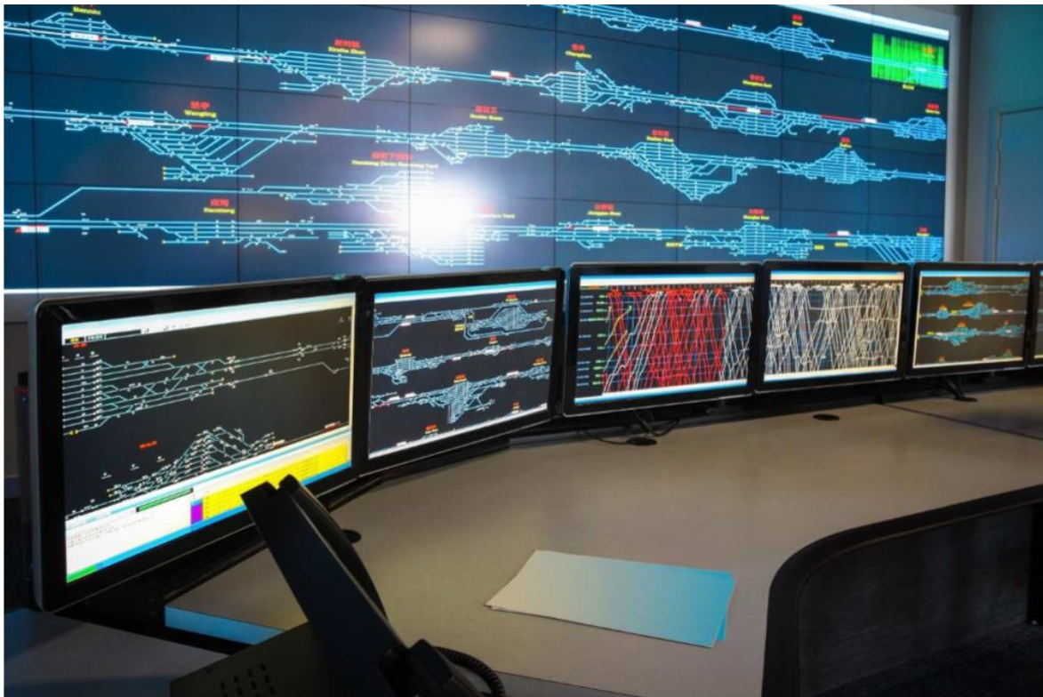
Slika 9. Prikaz sučelja u centru za dispečersko upravljanje željezničkim prometom
