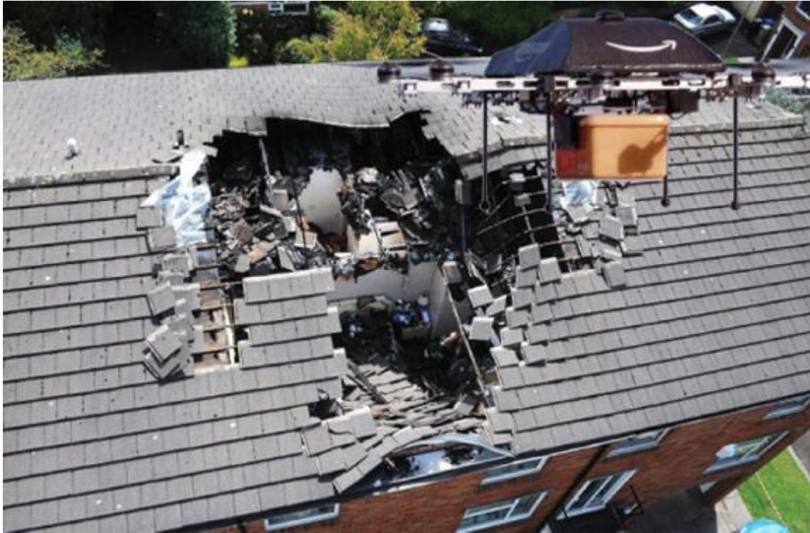
Slika 21. Inspekcija nastale štete korištenjem daljinski upravljivog drona
