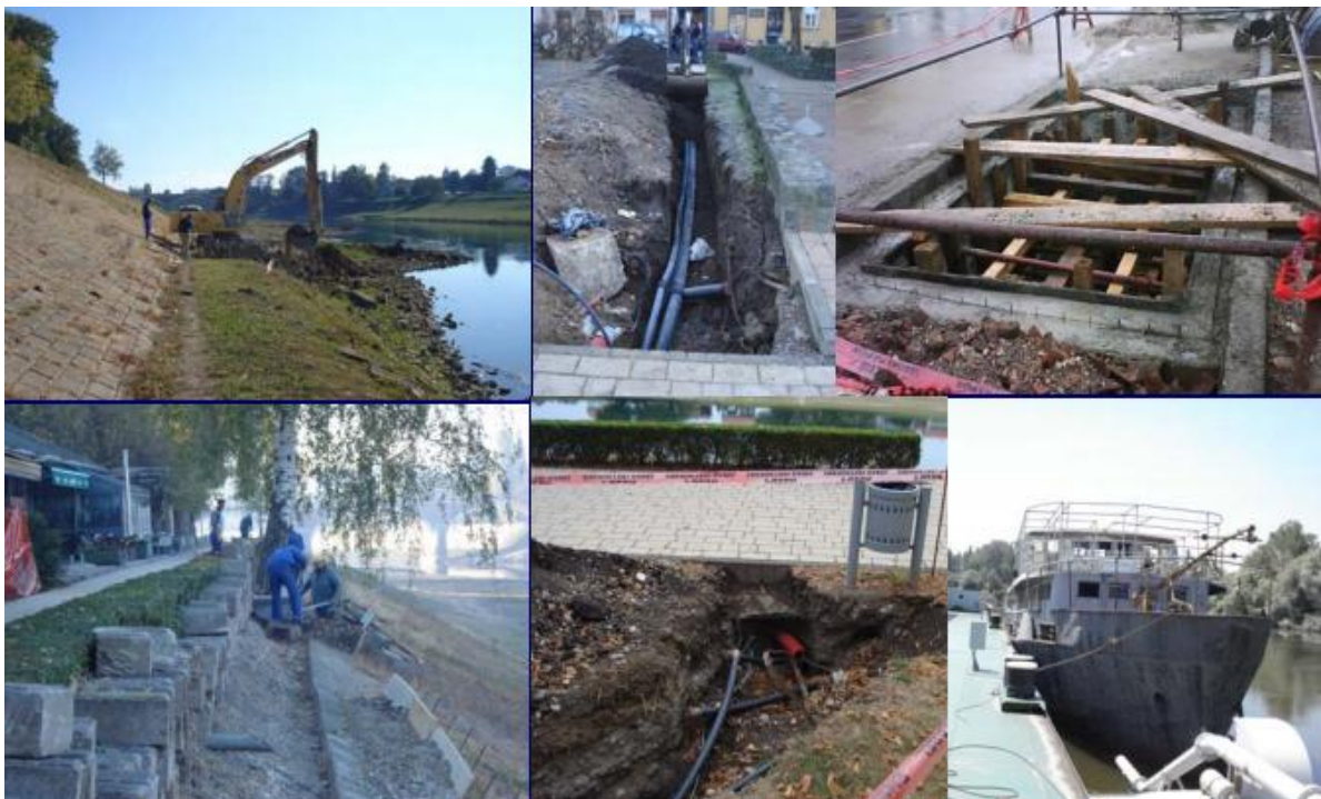
Slika 27. Započeti radovi na putničkom pristaništu Sisak Izvor: Vlahnić M. (2012.): Prezentacija: Javna ustanova Lučka uprava Sisak, Lučka uprava Sisak, Sisak
