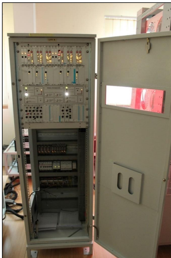
Slika 19. Upravljački ormar željezničko-cestovnog prijelaza
