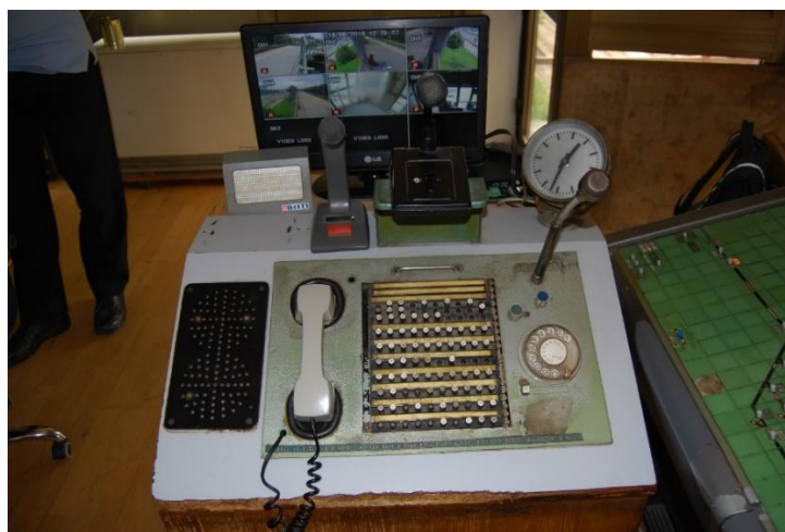
Slika 7. Telekomunikacijski pult u kolodvoru Karlovac
