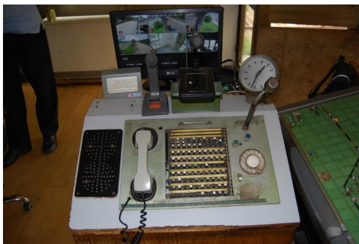
Slika 7. Telekomunikacijski pult u kolodvoru Karlovac
