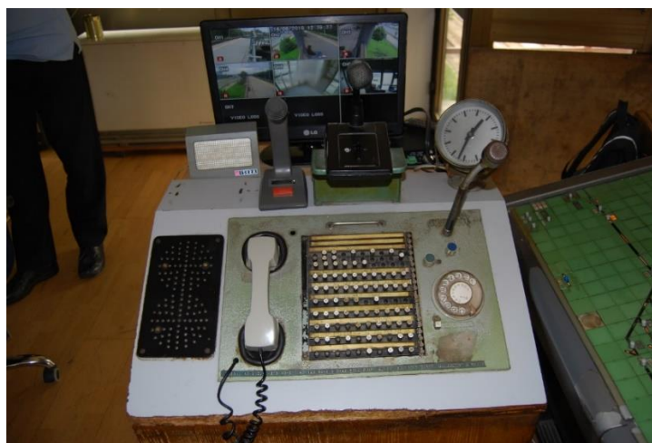
Slika 7. Telekomunikacijski pult u kolodvoru Karlovac
