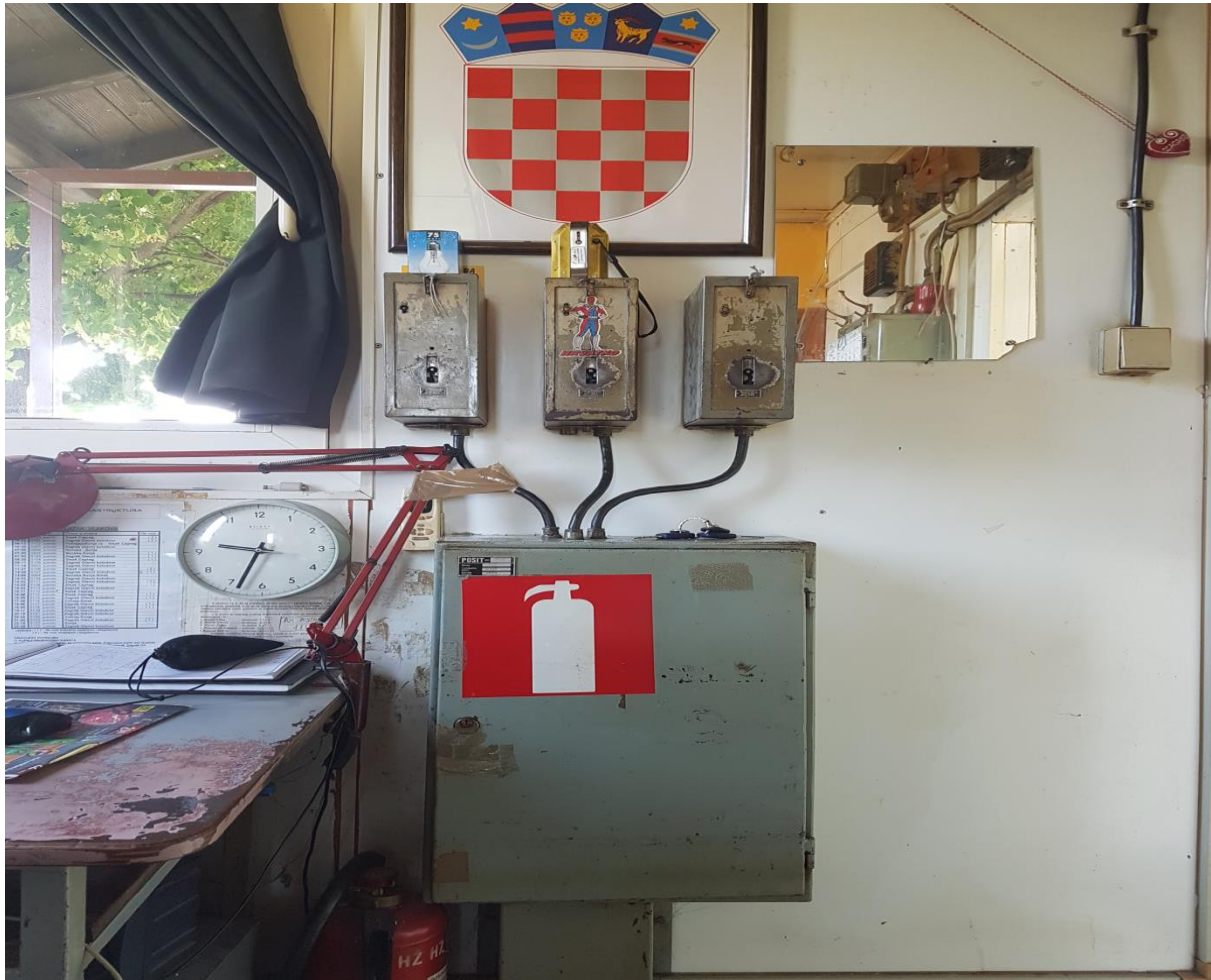
Slika 6. Elektromagnetske brave na Bloku 2
