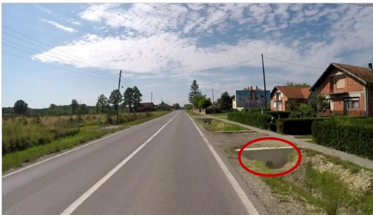
Slika 27. Prikaz opasnog mjesta s dubokim odvodnim kanalom i betonskim prijelazom [5]
