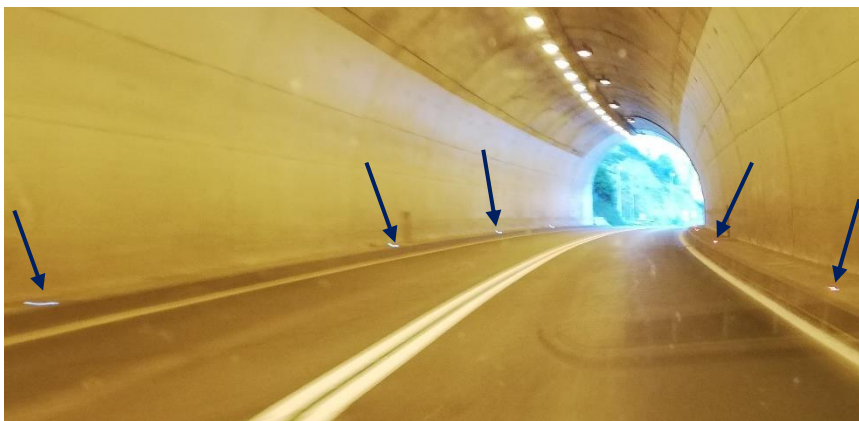
Slika 41. Smjerokazne oznake – markeri u tunelu Veliki Stog
