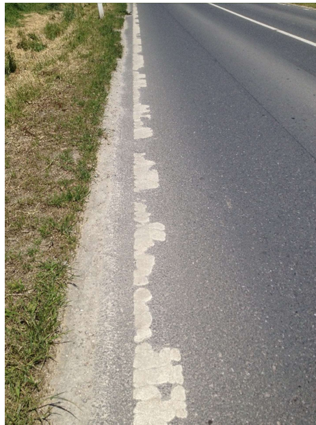
Slika 31. Prikaz oštećene i istrošene termoplastike
