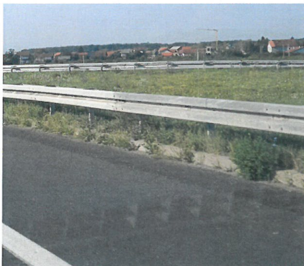
Slika 38. Primjer postavljanja jednostruke zaštitne ograde H1 na autocesti A4
