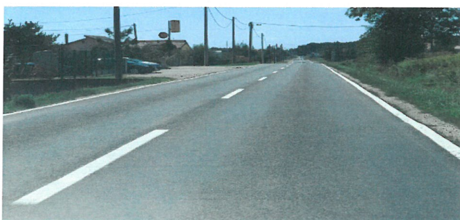
Slika 18. Primjer izvedbe uzdužne oznake na kolniku na D3 u naselju Donja Zelina izvedene kao isprekidana razdjelna i puna rubna crta
