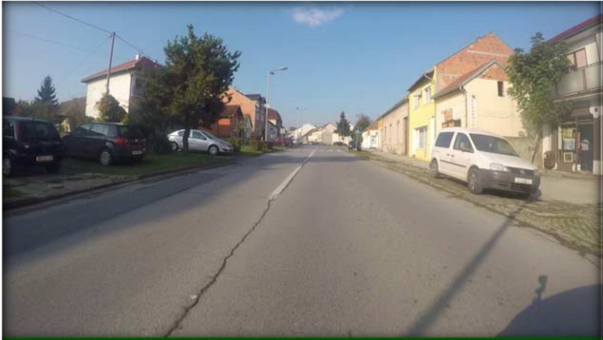
Slika 8. Prikaz pukotina na djelu Ulice braće Radić
