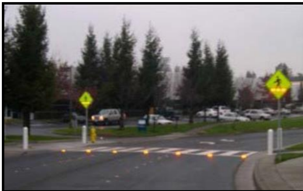
Slika 47 Pješački prijelaz sa LED prometnim svjetlima [16]
