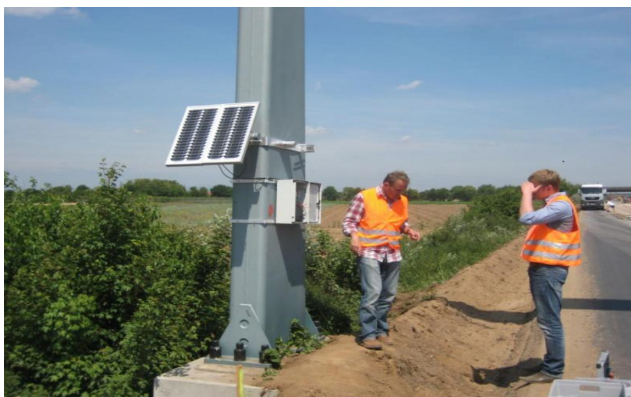
Slika 7. Postavljenje BLIDS senzora [19]
