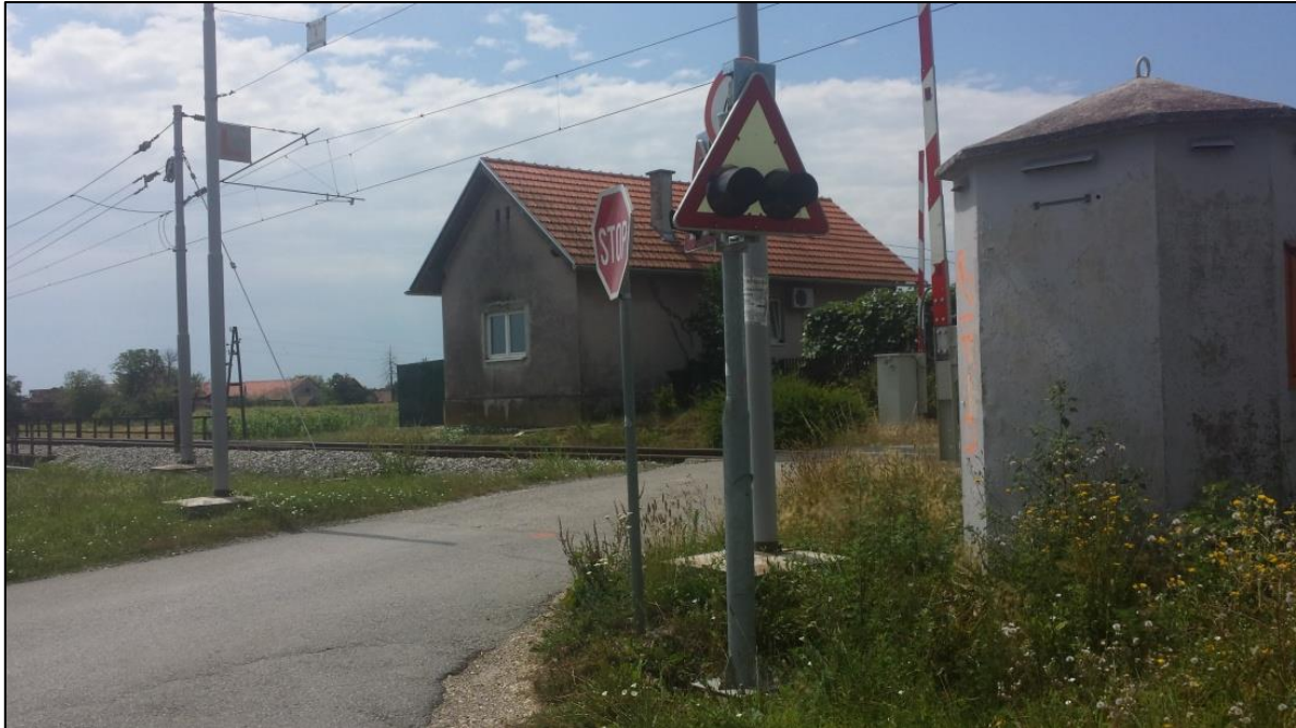
Slika 21. Svjetlosno zvučni signal na sporednoj cesti uz navedeni prijelaz
